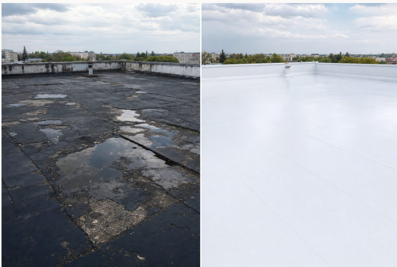
Vorher / Nachher: Ein klassisches Hamburger Bitumendach mit Rissen und stehender Nässe (links) und dieselbe Fläche nach der Sanierung mit Flüssigkunststoff-Abdichtung (rechts).
